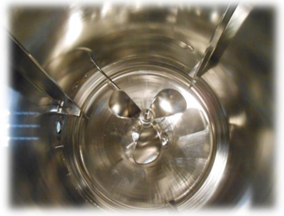
Figure 13 Exemple de photo prise en zone de production, bioréacteur, vue du hublot supérieur, [source auteur].
