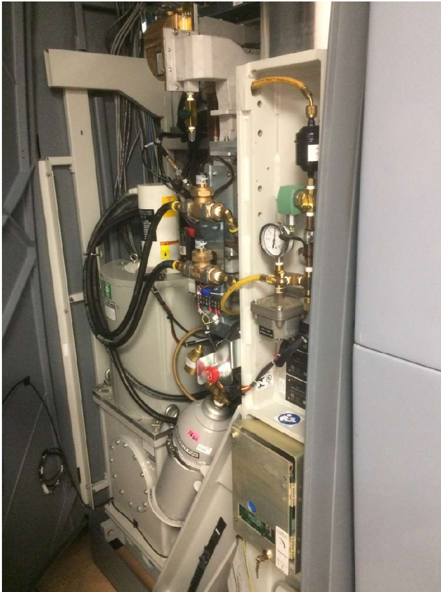
Figure 24: Klystron avec son alimentation et son système de refroidissement
