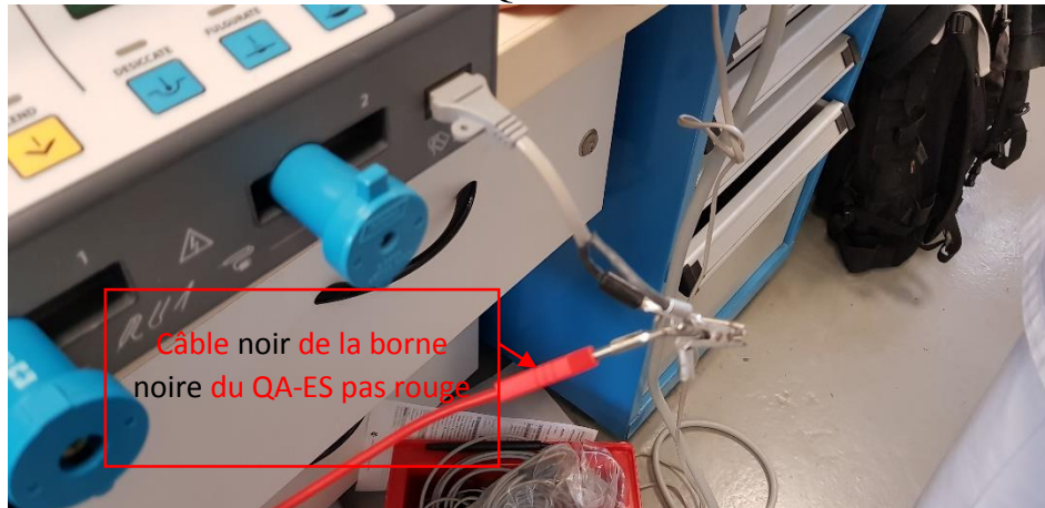
Figure 27 : Branchement du REM pour Mesure de puissance (source auteur)
